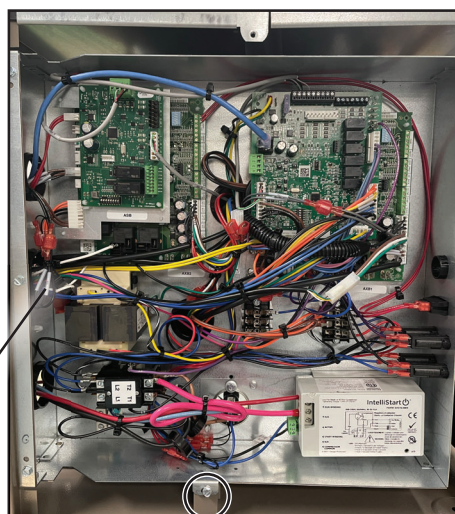
Figure 13B : Accès aux fils (boîtier de commande fermé)
